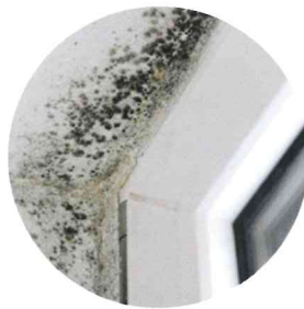
Moisissures sur les murs
